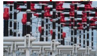
Stadtwerke Gas/Wasser/ Strom
